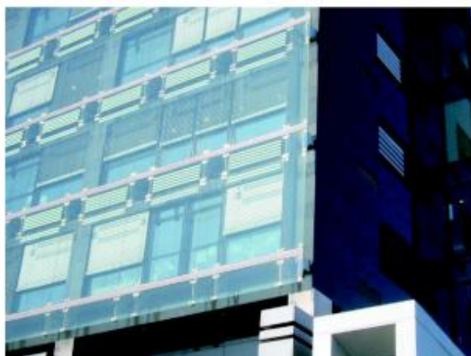
Przykład ekranu akustycznego zastosowanego na elewacji budynku Źródło: Bęben D., Hałas wokół szlaków transportowych , „Drogownictwo: 9/2010
